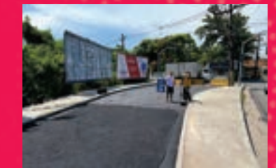
Implementação de semáforo - Brisa
